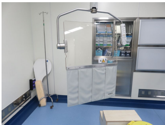
图 3-5 DSA 设备配备铅悬吊屏
