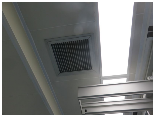
图 3-8 机房内排风口
