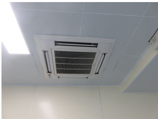
图 3-7 机房内空调进风口
