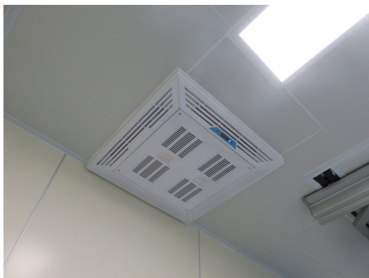
图 3-9 机房内空气消毒机
